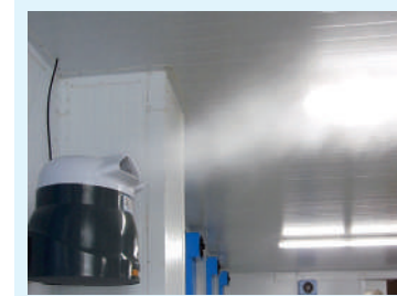
Umidificatore in funzione all'interno della cella.
