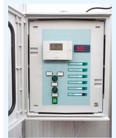
Control de temperatura y humedad en todas las áreas de la cámara, para una germinación homogénea .
