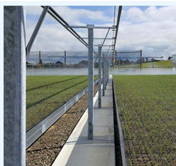
Impianto esterno con palo centrale singolo .
