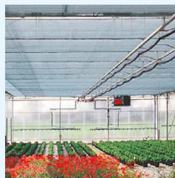
Irrigatore in serra con schermo termico . Traversa superiore sagomata ad omega per la presenza di un generatore.
