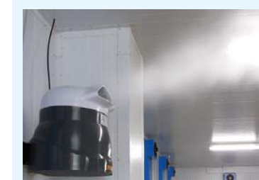
Umidificatore in funzione all'interno della cella.
